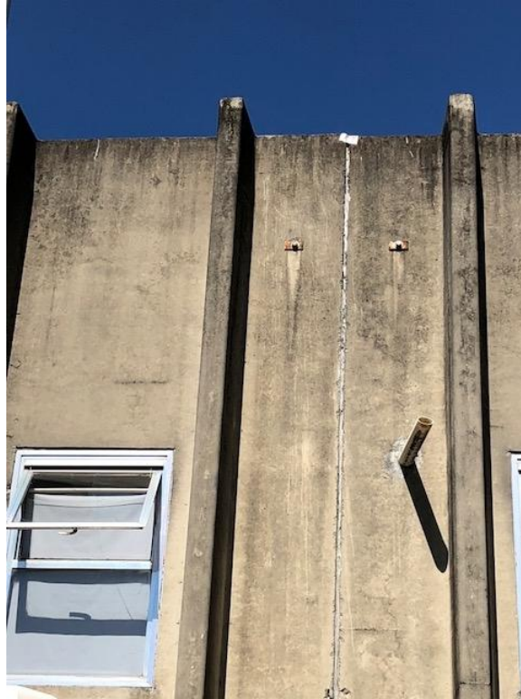
Foto 7: Fachada do Prédio 100 – Junta de Dilatação vertical
