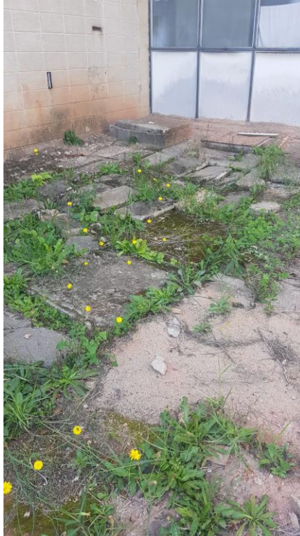
Foto 10: Laje que gera infiltração no pavimento abaixo
