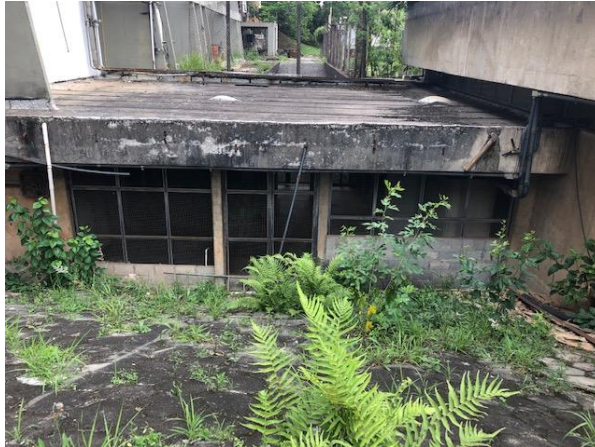
Foto 12: Local em que não há laje abaixo, trata-se de um talude em 45°.
