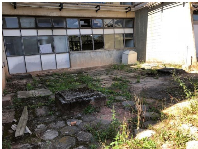
Foto 11: Laje que gera infiltração no pavimento abaixo
